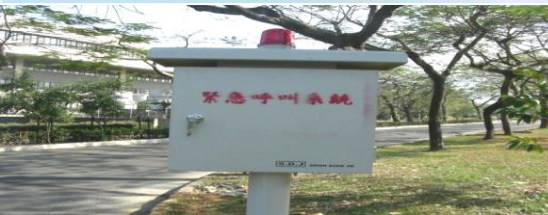
緊急呼叫系統設施
